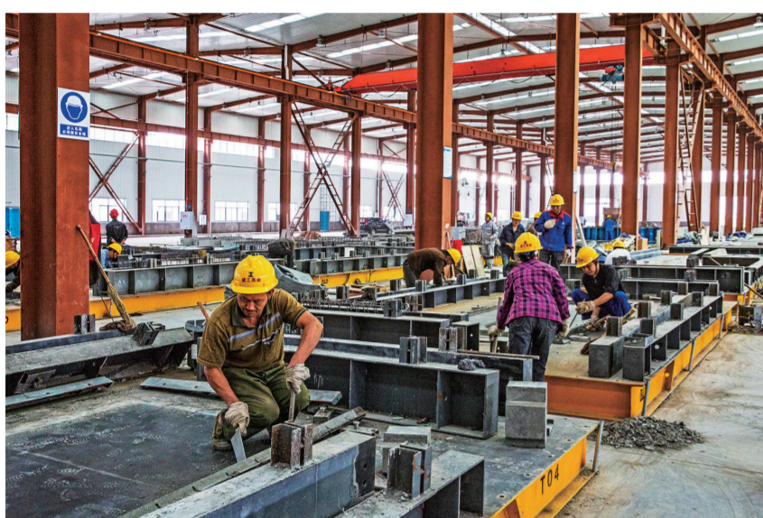
位于桥河工业园区的重庆建工集团高新建材责任有限公司装配式建筑构件生产车间。
