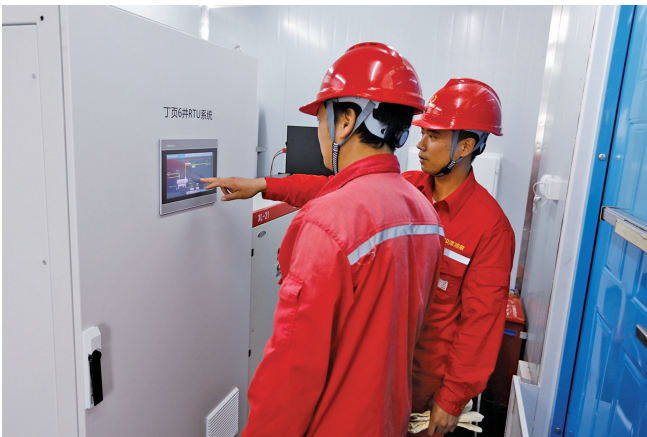
在中国石化西南油气分公司采气四厂丁页6平台,工作人员正在操作设备。
