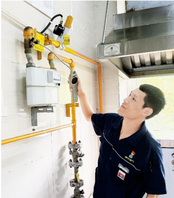
重庆港华燃气有限公司党员职工上门为居民检查燃气安全。綦江区委社会工作部供图
