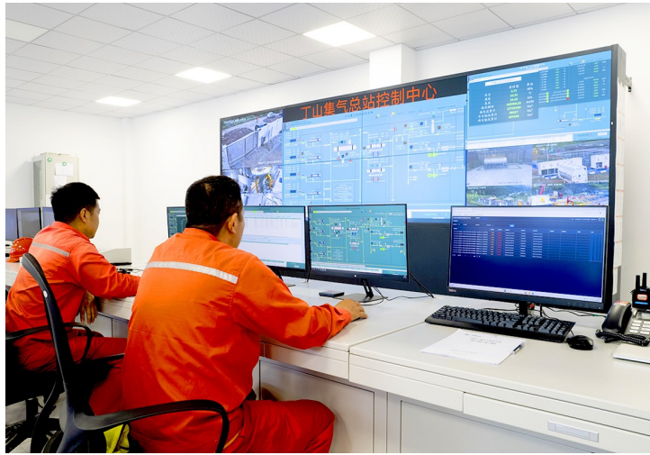
在丁山集气总站中控区,工作人员实时监看生产数据,精准监控气田集气、增压全流程运行状态。 记者 周禹 摄
