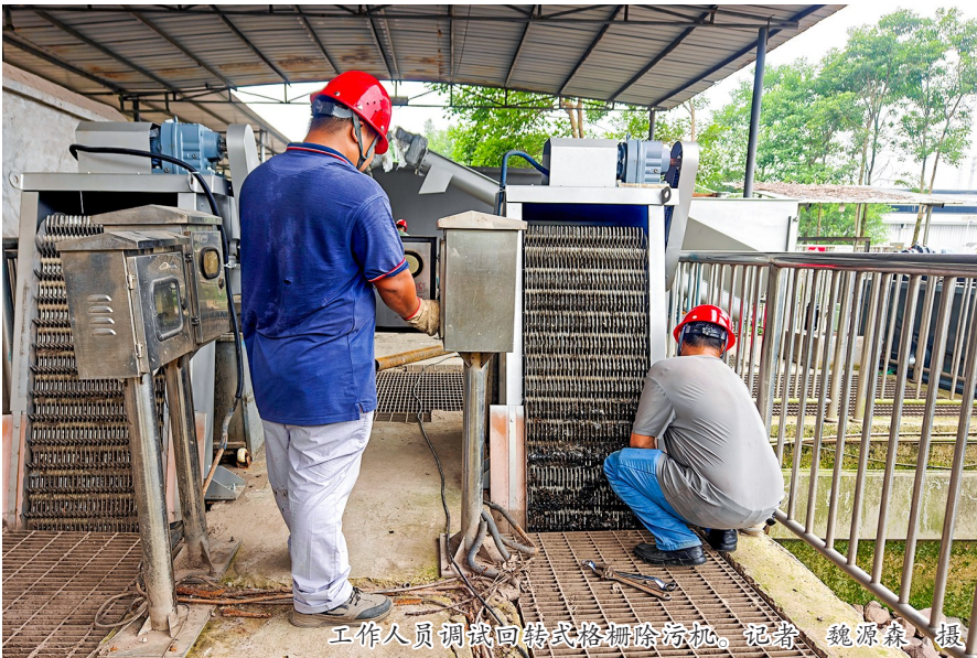
工作人员调试回转式格栅除污机。记者 魏源森 摄
